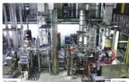
已完成安装的2MW/140GHz长脉冲ECRH系统
